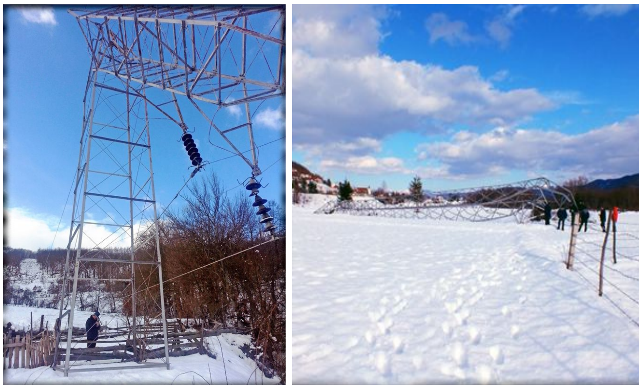
Slika 32. Havarije na stubovima nadzemnog voda 110 kV Berane-Andrijevice
