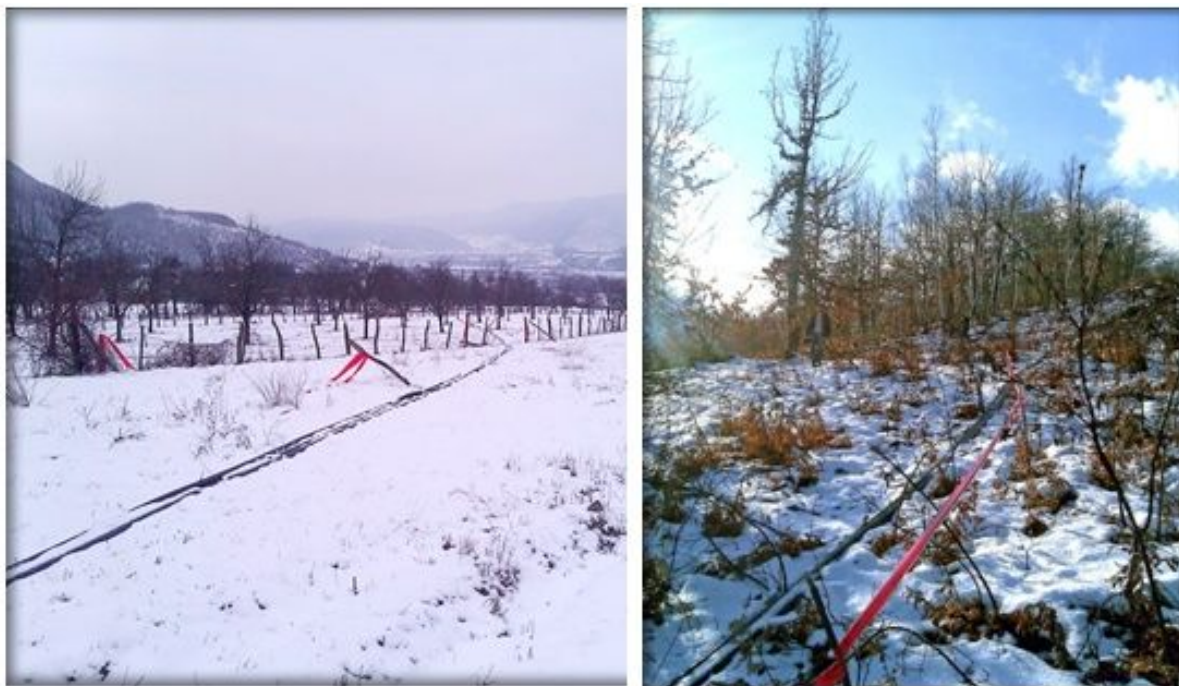
Slika 33. Improvizovano rješenje napajanja Andrijevice iz pravca Berana, 35 kV kabal
